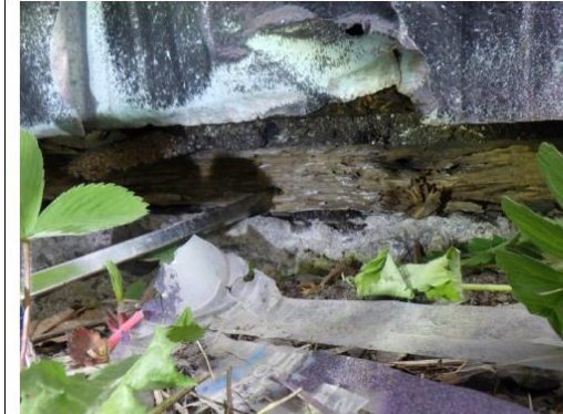
Structure photo 25- Dommages au mur porteur en bois
