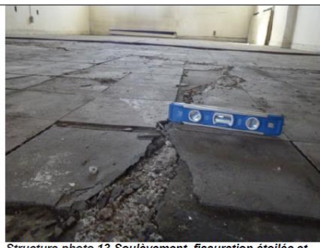
Structure photo 13-Soulèvement, fissuration étoilée et sulfatation/effritement visible de la dalle de béton
