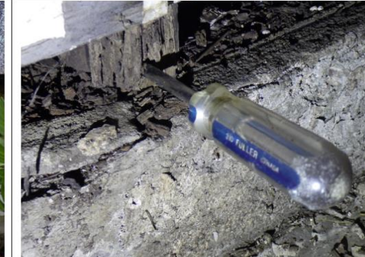
Structure photo 26- Dommages à un poteau mural en bois
