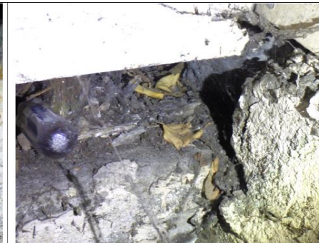
Intérieur photo 8- Dommages et pourriture visibles à la base des cloisons murales (murs extérieurs) ;
