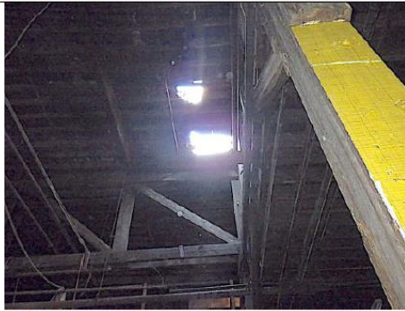
Structure photo 19-Trous à ciel ouvert à la toiture
