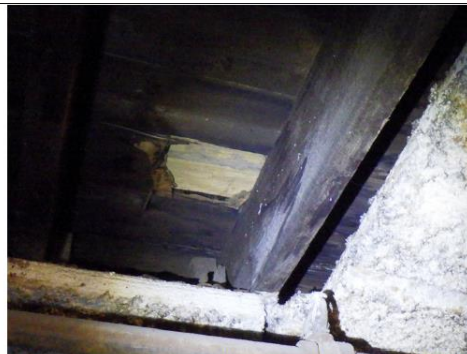
Intérieur photo 7- Traces d'eau, sur plusieurs surfaces de bois (bâtiment principal) ;
