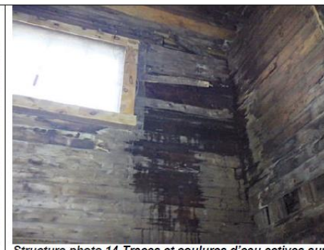
Structure photo 14-Traces et coulures d'eau actives sur les murs
