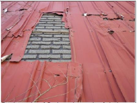
Enveloppe photo 2-Parties endommagées, froissées, déchirées et manquantes sur le revêtement mural de tôle ;
