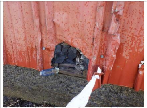
Enveloppe photo 1-Parties endommagées, froissées, déchirées et manquantes sur le revêtement mural de tôle ;
